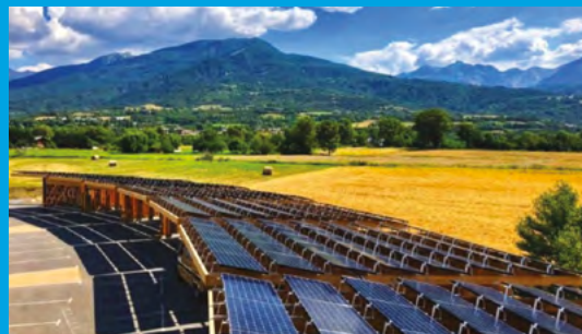
Création d'une ombrière de production d'énergie solaire avec le Syndicat Mixte de l'Energie des Hautes-Alpes, 2018. © SYME 05.
